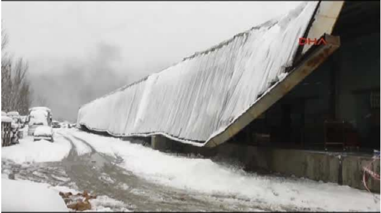
Şekil 1. İnegöl hal binasının kar yağışı sonrası göçmüş haldeki görünümü [1]
